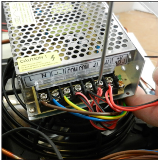
E5. Trennen Sie die defekten Led Streifen vom Netzteil
