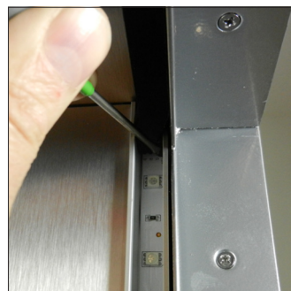
E2. Die defekten Led-Streifen herausnehmen mit Hilfe eines Schraubenziehers
