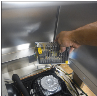
D1. Fehlerhaftes Netzteil entfernen (ist auf der inneren Wand der Wanne gesichert)
