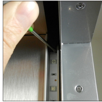
E6. Die defekten Led-Streifen herausnehmen mit Hilfe eines Schraubenziehers
