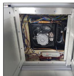
A5 . Vano condensatore
