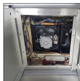
A5 . Compartimento del condensador
