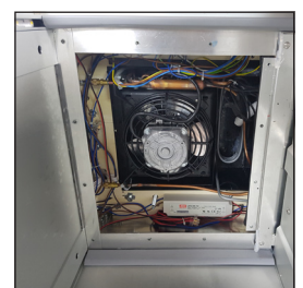
A5 . Compartimento del condensador
